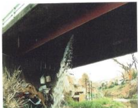
水道配水管（加茂 3 号橋 1 月 17 日）
